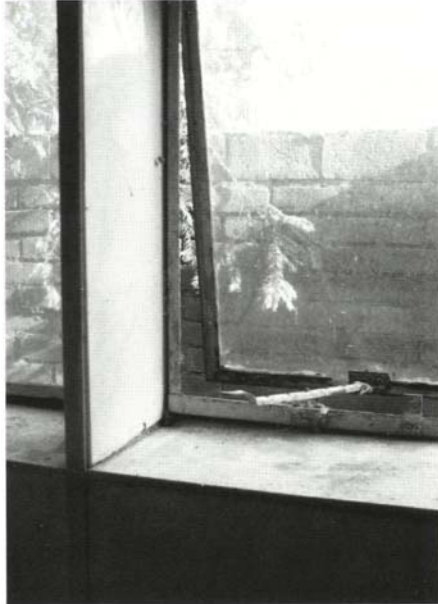
Detail raam en paneel exterieur. Coll. architectenbureau Veldman & Rietbroek / bureau Monumenten & Archeologie van de gemeente Leiden.
