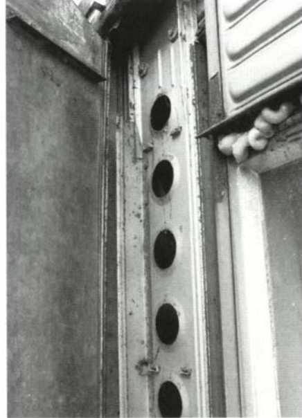
Detail raam interieur. Coll. architectenbureau Veldman & Rietbroek / bureau Monumenten & Archeologie van de gemeente Leiden.
